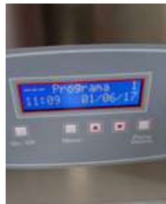
Detalle Panel Mandos BV
