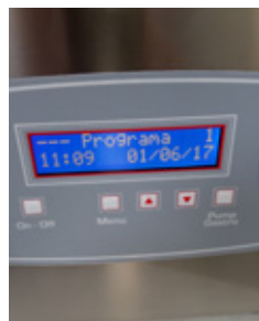
Detalle Panel Mandos BV
